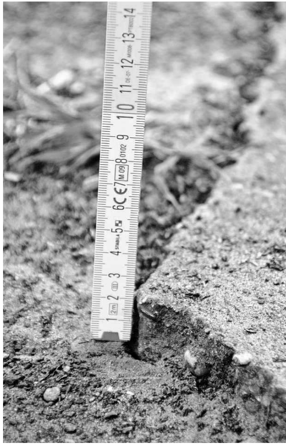
An vielen Stellen sind die Betonplatten gerissen und gebrochen. Mehrere Zentimeter hoch ragen die Kanten aus dem Boden. FOTOS: GABRIELA KELLER
